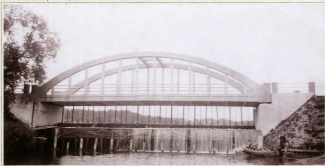
Tilto per Musės upę Čiobiškyje ilgis 28,20 m, plotis 5,9 m, aukštis 6,5 m.
