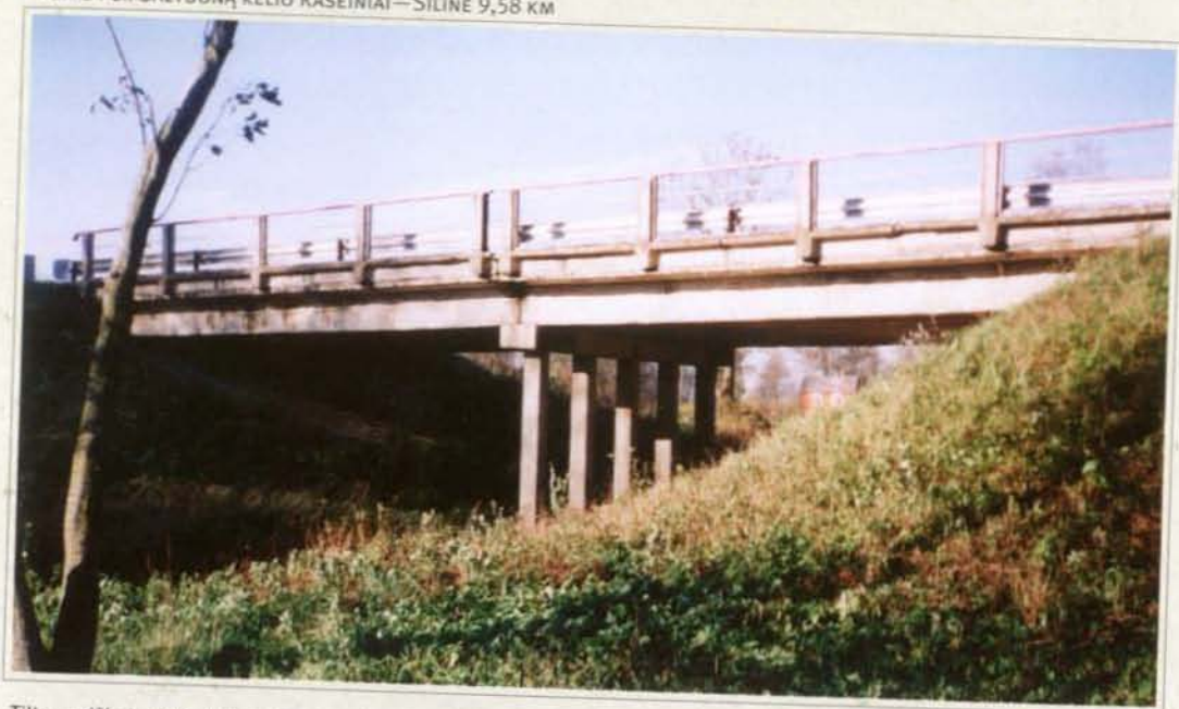
Tiltas gelžbetoninis, dviejų tarpatramių, sijinis, karpytasis, 34,16 m ilgio. Tarpinė atrama — penki poliai sujungti gelžbetoniniu rygelio.
