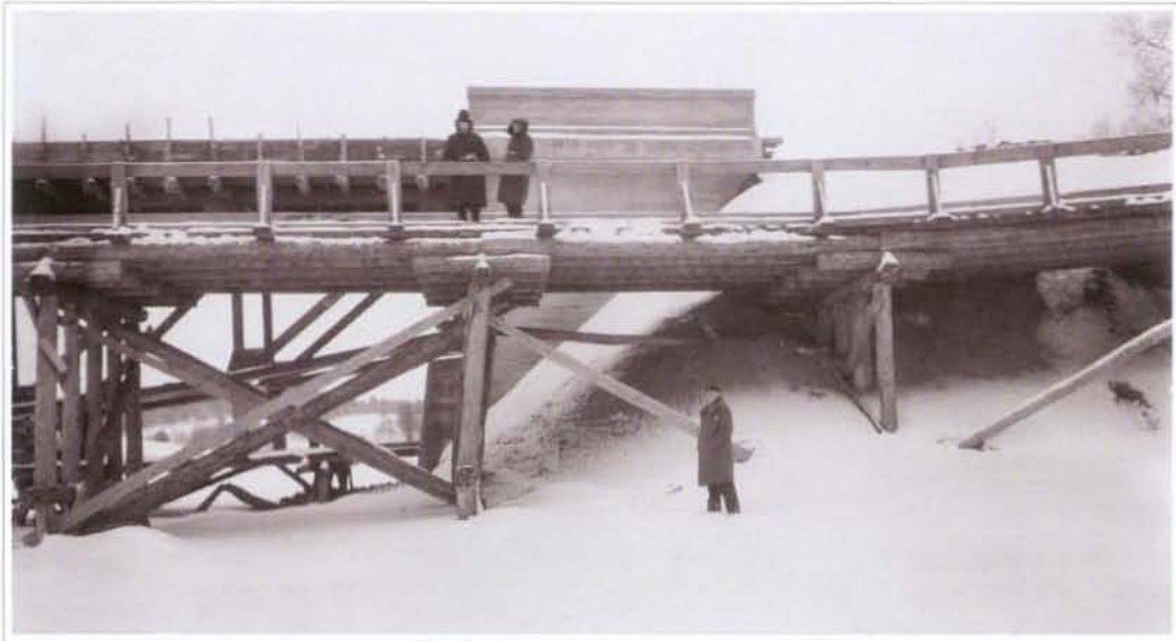
Gelžbetoninio tilto statyba Ukmergėje per Šventąją 1931 m. sausio 7 d. Ramtas ir medinis tiltas dešiniajame krante.
